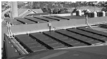
【資料:太陽熱高度利用システムフィールド事業平成 18 年度設置事例集】
